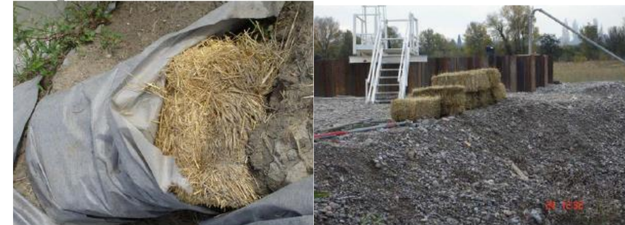
Illustration 243 : Filtres à pailles (Source photo : CETE)
