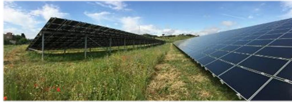
Illustration 238 : Exemple de fauche sur un parc photovoltaïque
